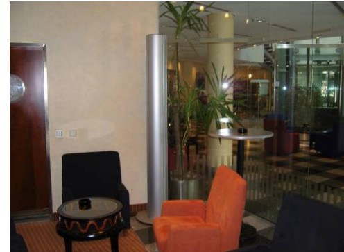
Luftreiniger AirOne in einem Raucherraum
